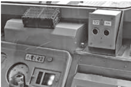
写真3：郊外電車運転席にある架線電圧切替スイッチ
